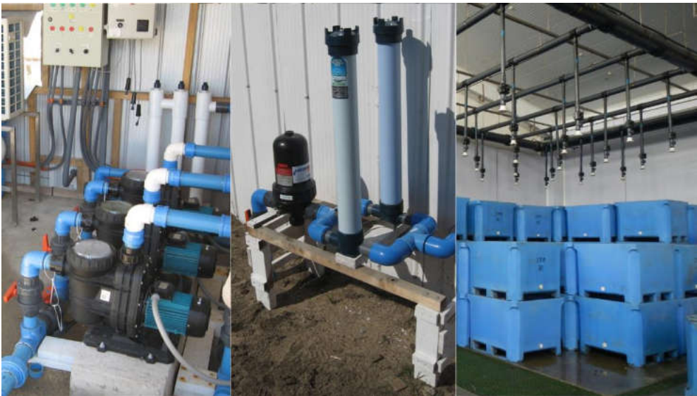
Figura 17. Exemplos de estruturas e equipamentos usados para a captação, tratamento e distribuição de água. Da esquerda para a direita: bombas hidráulicas; sistema de filtragem e equipamento de desinfecção de água por luz ultravioleta; encanamento para distribuição de água para tanques de depuração
