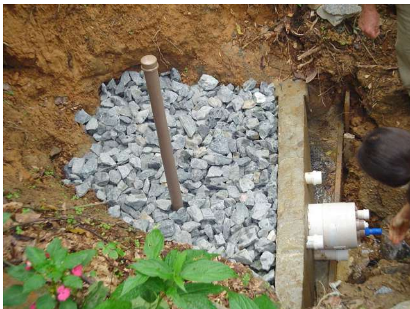
Figura 16. Construir o leito filtrante com preenchimento do local com pedras de rio ou brita nº4, lavadas e desinfetadas. Completar com pedras até cobrir completamente o tubo
