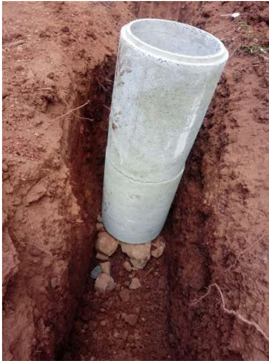
Figura 27. Posteriormente, colocar pedras em volta do tubo para fixá-lo “em pé” e preencher todo o espaço existente. A extremidade do tubo deve ficar 50cm acima da superfície do solo
