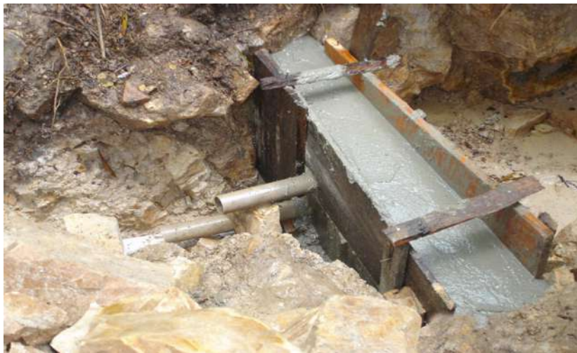
Figura 32. Após escolher o local, construir uma estrutura em alvenaria e assim criar um pequeno reservatório de água. A mesma poderá ser construída totalmente em concreto, utilizando para isso formas de madeira (caixaria) ou de tijolo. Nessa estrutura, concretar os canos de PVC: o cano-ladrão, na parte superior; o cano de limpeza, na parte inferior; o(s) cano(s) para saída da água (encanamento), na parte central da estrutura
