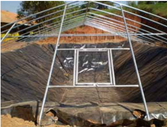
Figura 6. Estrutura de sustentação com cano galvanizado, resistente à umidade e a oscilações de temperatura
