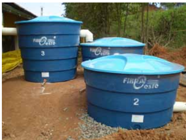
Figura 10. Sistema de pré-filtragem composto por uma caixa de sedimentação (desvio da primeira chuva) e duas caixas de pré-filtragem
