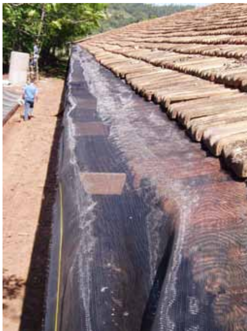
Figura 8. Telhado de captação com detalhe da calha em PEAD revestida com “sombrite”
