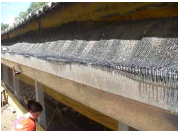
Figura 9. Calha de metal protegida com “sombrite”
