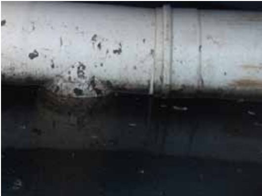
Figura 11. Detalhe da caixa de sedimentação
