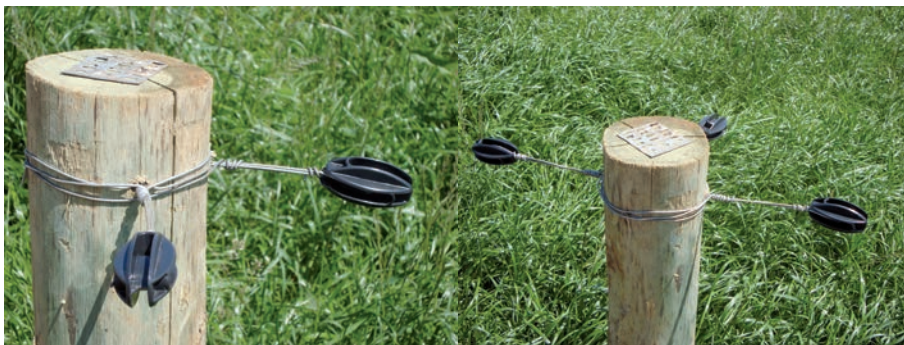
Figuras 26 e 27. Detalhe de instalação de castanhas e isoladores intermediários
