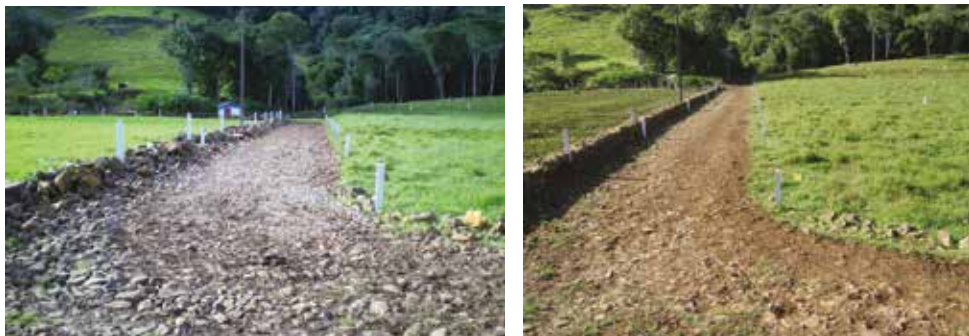
Figura 35. Detalhe da alocação e revestimento dos corredores com pedras: detalhe construtivo inicial (esquerda) e finalizado e compactado (direita)
