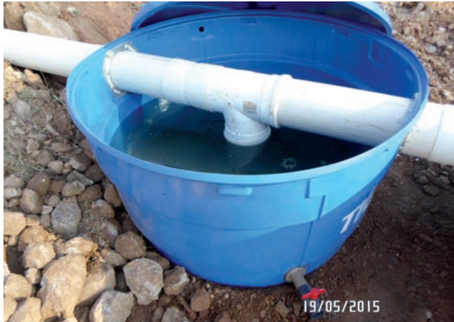
Figura 11. Detalhe da caixa de sedimentação
