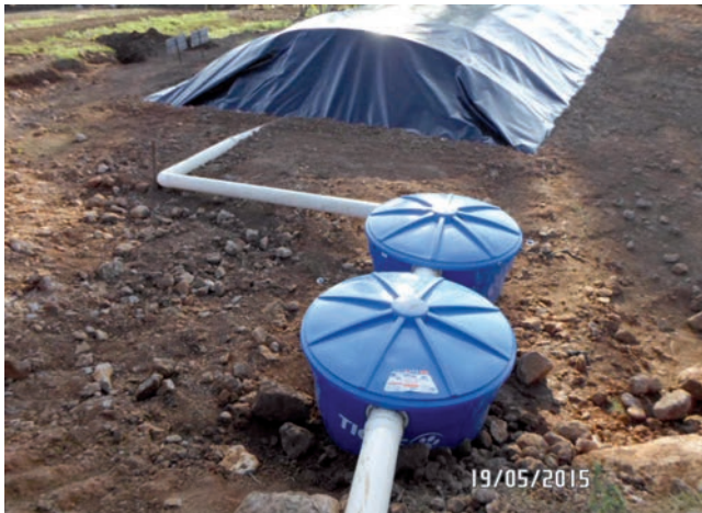
Figura 10. Sistema de pré-filtragem composto por uma caixa de sedimentação (desvio da primeira chuva) e uma caixa de pré-filtragem
