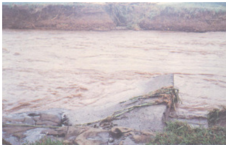
Enchente rompe a barragem em dezembro de 1995...
