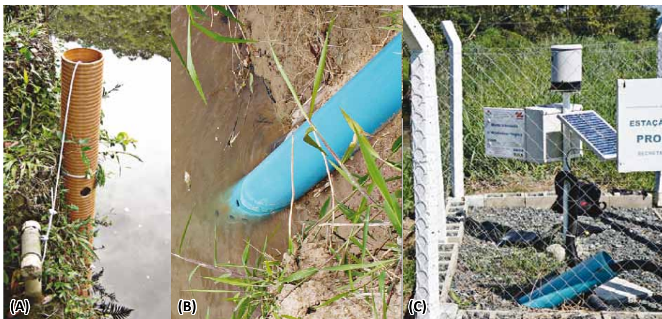
Figura 1. (A) Sonda instalada na vertical em barragem de captação de água e (B) sonda instalada em margem de rio com talude de terra, com (C) alimentação por bateria e painel solar
